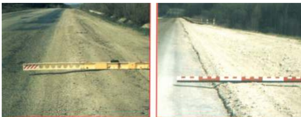
Рис. 4. Пример завышения обочин по отношению к проезжей части дороги при отсутствии бордюра
