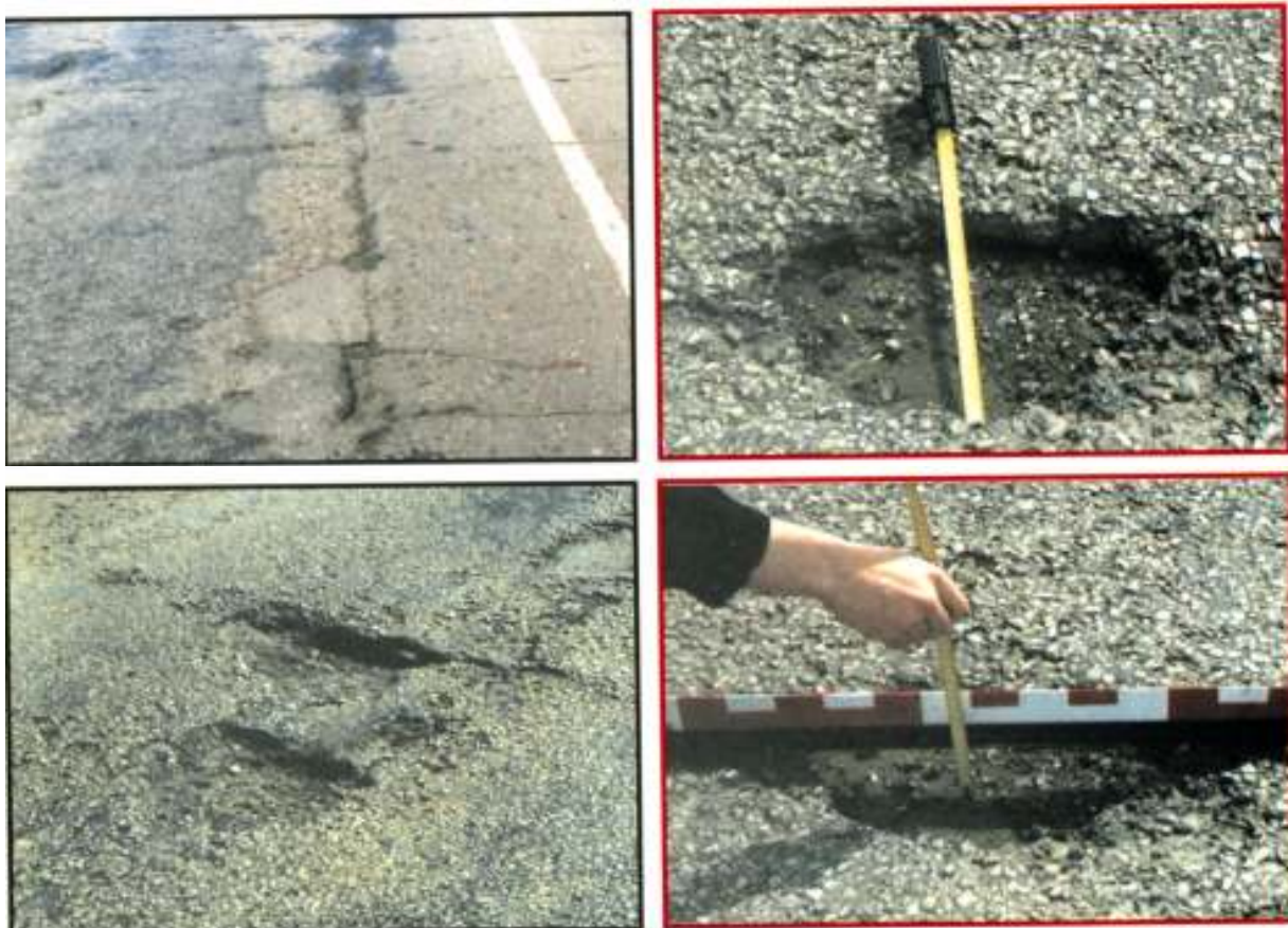
Рис. 1. Виды дефектов на проезжей части
